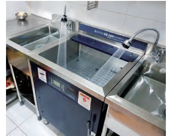
에코워시가 설치된 모습
